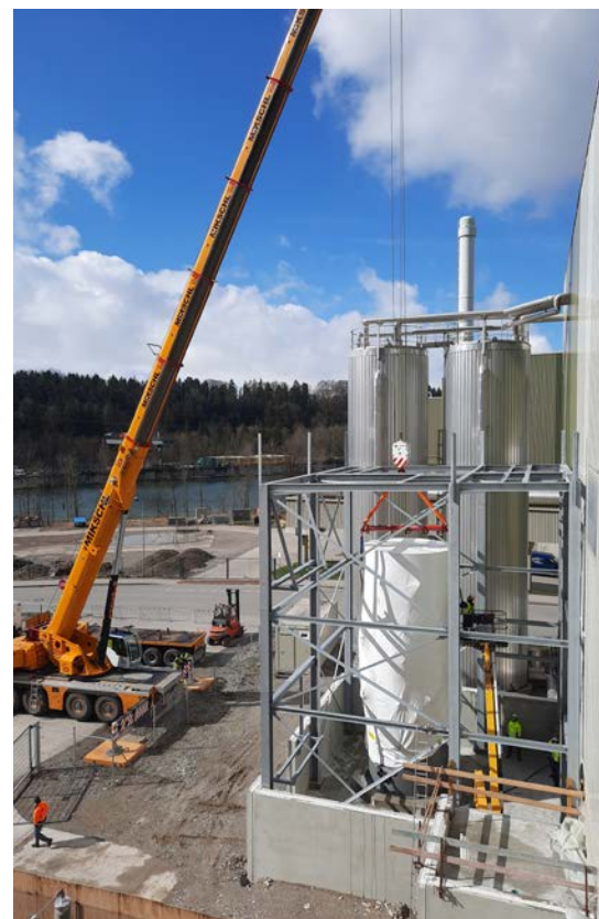
Aufstellung Elektroboiler zur Dampferzeugung.
